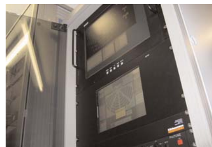
Kontrollzentrum im Hintergrund
